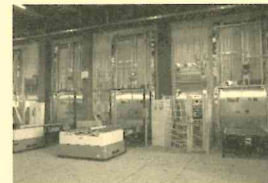
新冷蔵庫及び自動搬送システム
