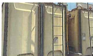
・冷却殺菌海水貯蔵タンク
