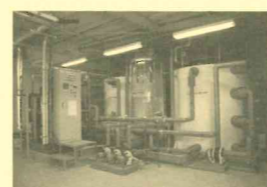
無菌海水シャーベット製造「製氷室」
