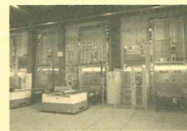
新冷蔵庫及び自動搬送システム
